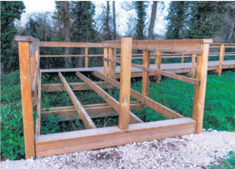
Foram furtados cerca de 20 m2 de estrado e 30 postes balizadores
