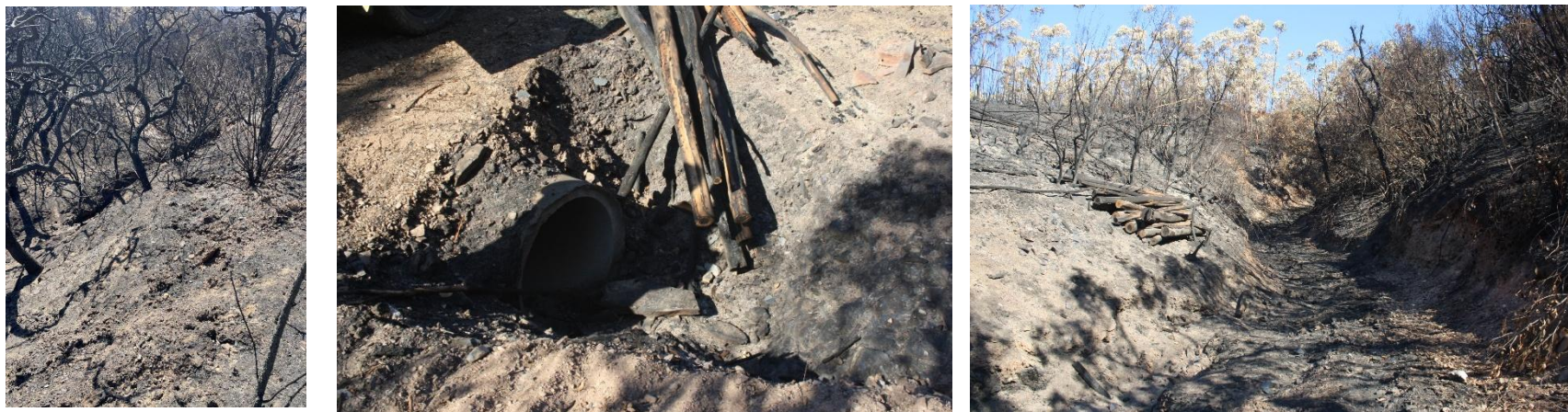
Imagem 7: Linhas de água e estruturas hidráulicas afetadas
