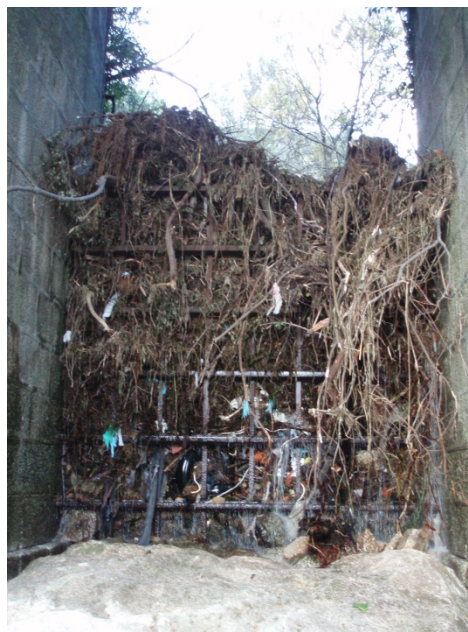
Material arrastado pelas águas que se acumulou debaixo de uma ponte na EN 231 (Alvoco).
