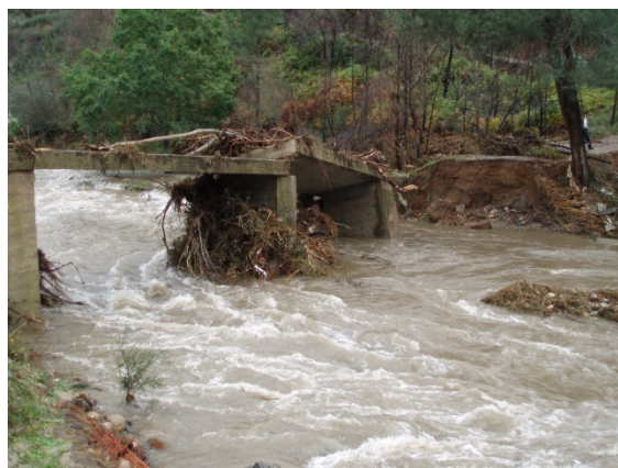
Ponte destruída em Vasco Esteves, Alvoco da Serra.
