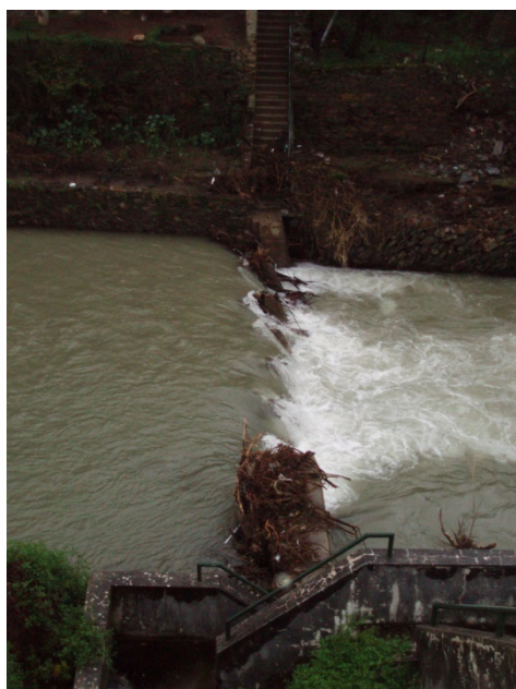
Açude caneiro parcialmente destruído (Vide).
