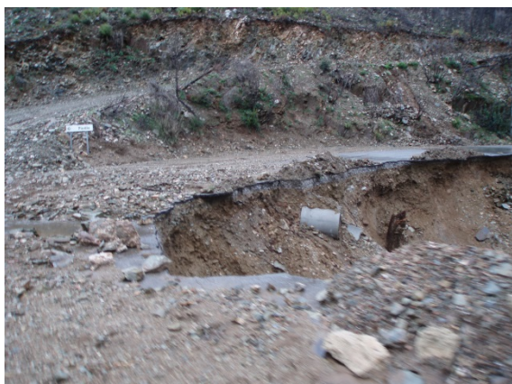
A estrada municipal Vide – Gondufo foi muito afetada, em especial no cruzamento do Piódão.
