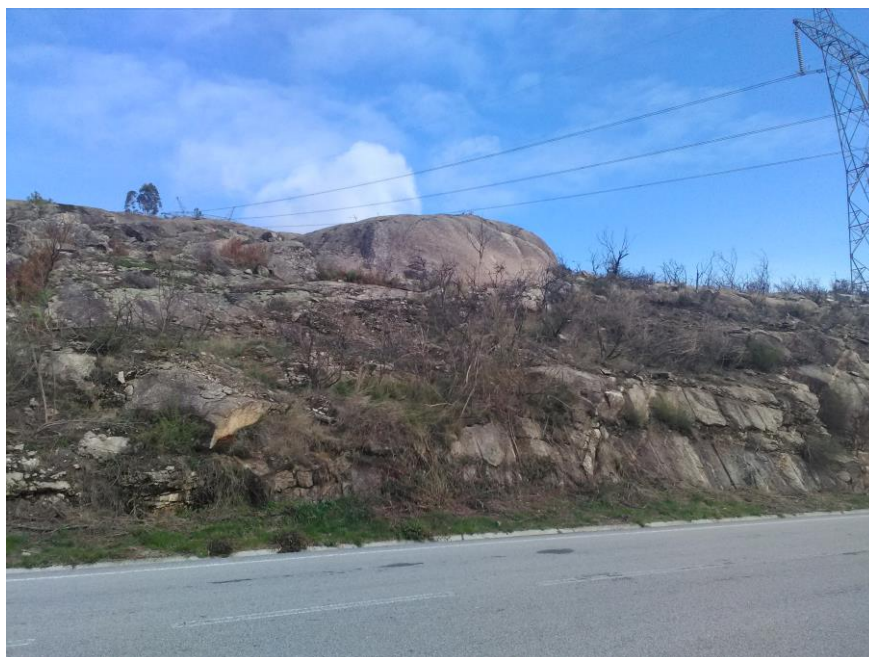
Figura 2- Zona com necessidade de intervenção ao nível da estabilização de emergência – Via Panorâmica – Freguesia de Penamaior
